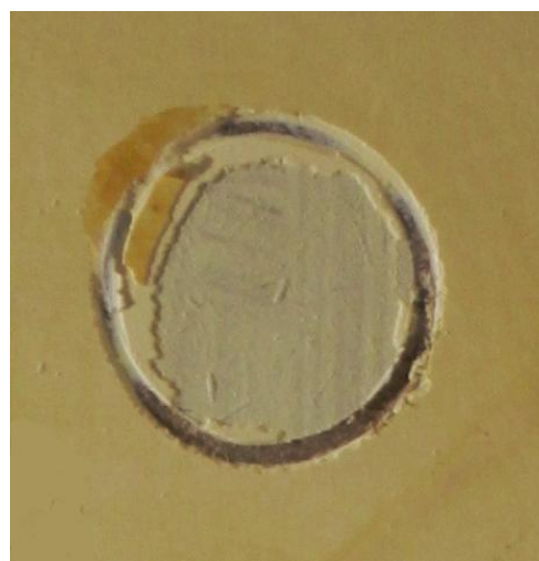
Фото 5. Отрыв венцианской штукатурки «Дорос» от DECOR FONDO UCIC толщина оторванного слоя 220 мкм, адгезия 0,1 МПа
