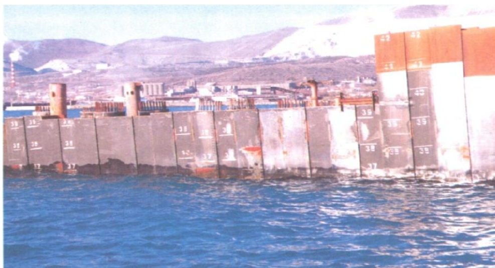
Рис. 1. Вид сегмента шпунтовой стены после шторма
